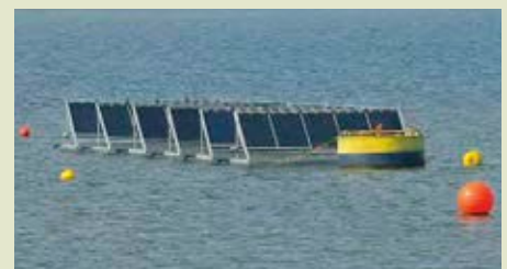
Proef met zonnepanelen op water in slibdepot De Slufter.
