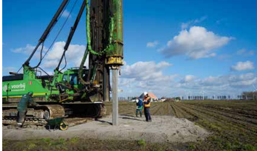
Wiebren Koers (met oranje hesje) begeleidt het heien van de palen met zijn collega's van Voorbij Funderingstechniek, feb 2017.
